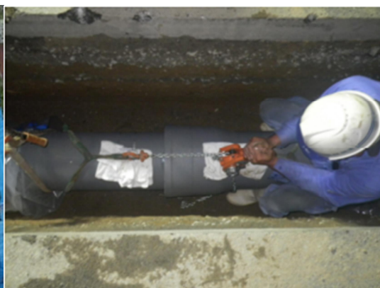
【岡山市瀬戸町線送水管 (GX 耐震管)】
