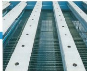
4 薬品沈でん池
