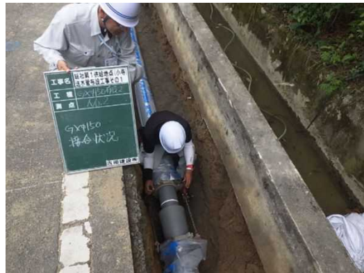
【総社第1供給地点(小寺)送水管 (GX耐震管)】
